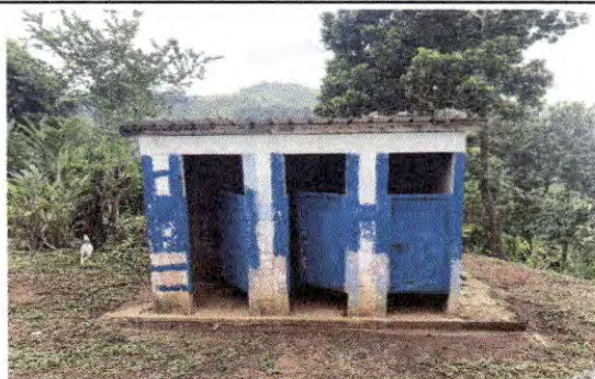
Foto 8: Sanitarios en pésimo estado.
