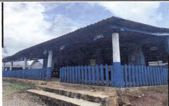
Foto 7: techo de lamina en aulas en mal estado, vista desde angulo exterior.
