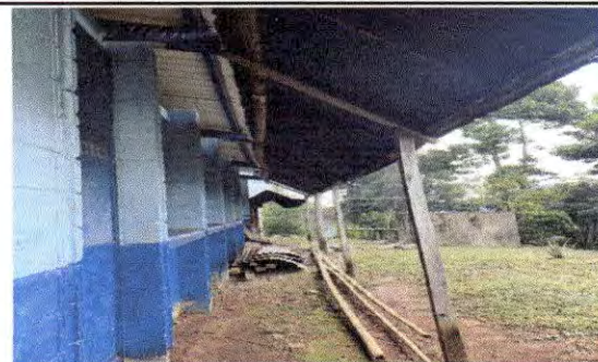
Foto 11: Pasillo de módulo 1 con daños severos.
