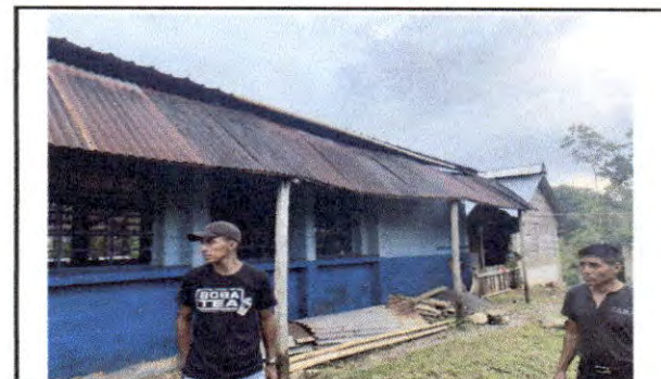
Foto 4: Láminas en estado depreciable.
