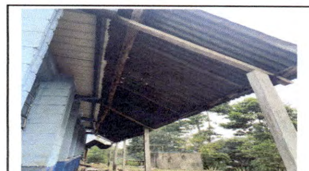
Foto 6: Estructura de madera en malas condiciones.
