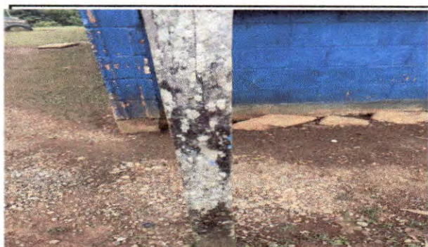
Foto 2: Estructura de madera en muy malas condiciones.
