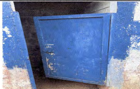
Foto 10: Puertas con óxido.
