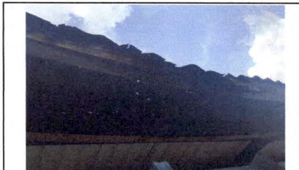
Foto 3: Láminas con filtraciones.
